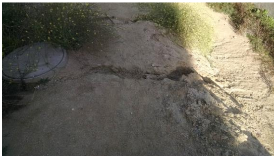
Figura 2.3 Agrietamiento de terreno y talud
