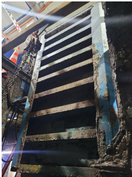
Figura 1-3. Estructura de Prensa Corroída, Fuente: Elaboración Propia, Visitas a terreno
