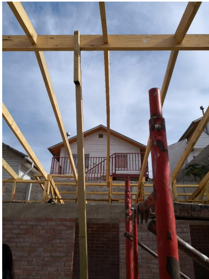
Figura 2.8: Deformación en el envigado de madera
