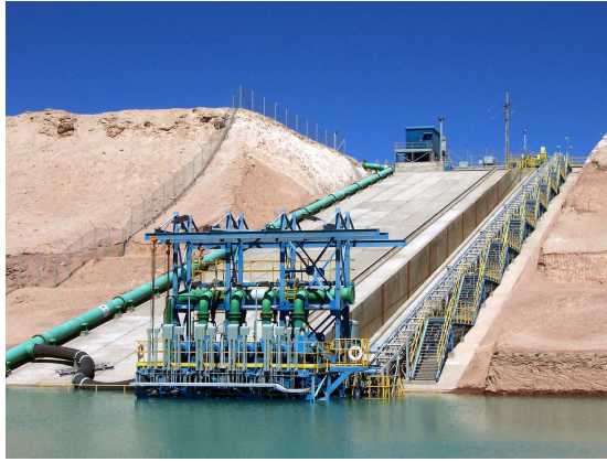
Figura 3.8: Estación de Bombeo PS0 – Tranque Talabre – Chuquicamata [5].
