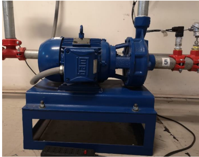
Figura 4.2: Bomba centrífuga Vogt H620, junto con motor eléctrico Weg W-22.
