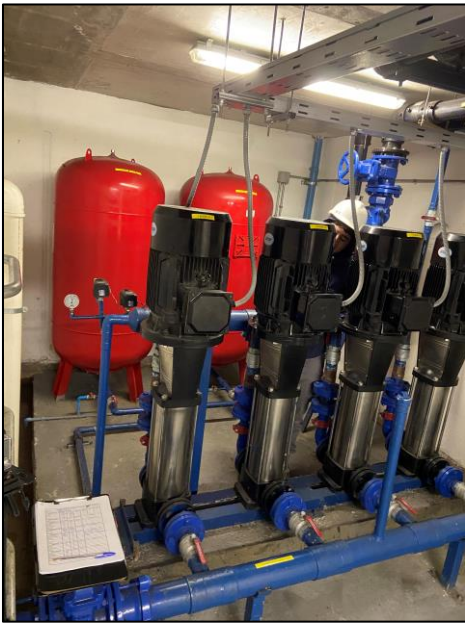
Figura D-1: Bombas y Estanques Hidroneumáticos. Fuente: Elaboración propia
