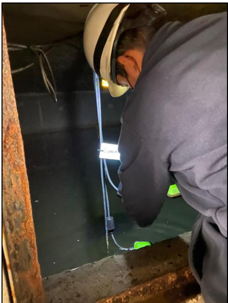
Figura D-4: Sensores de nivel, Estanque de Agua.
