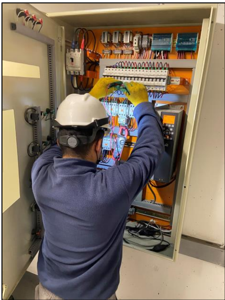
Figura D-3: Tablero eléctrico.
