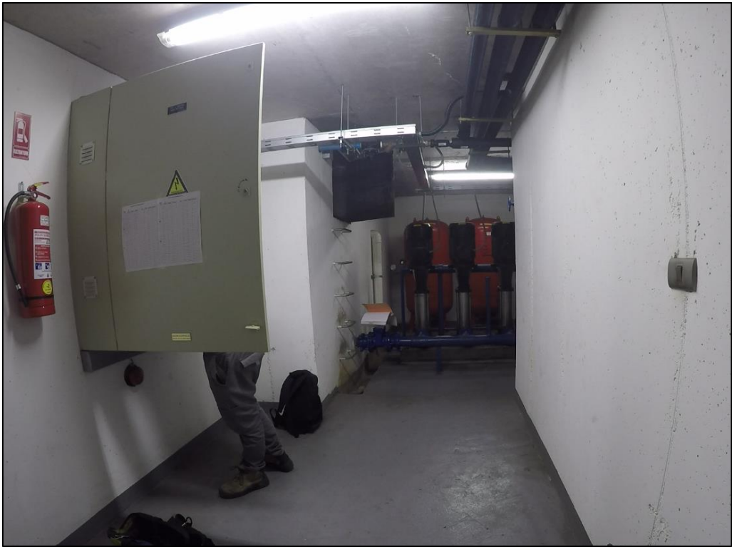
Figura D-6: Sala de Bombas.
