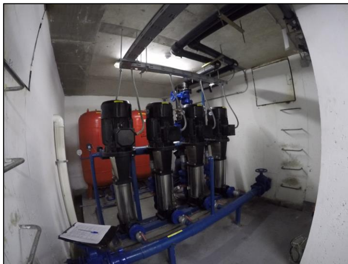
Figura 1-1: Sala de bombas Condominio Cormorán II y III, torre B.
