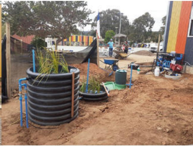
Fotografía 13. Sistemas de reutilización de aguas en Escuela El Yeco. Ecological.
