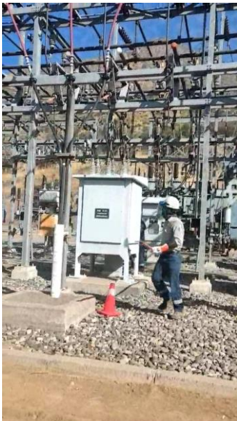
Figura 2.- Operador de Guardia de Operaciones realizando tarea de cierre de desconector
