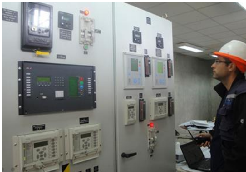
Figura 5.- Revisión de tableros de corriente
