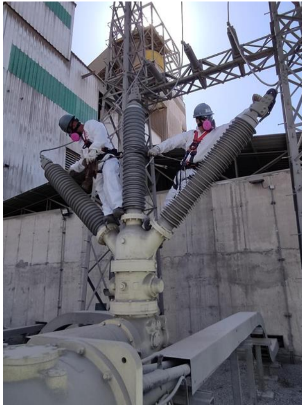
Figura 4.- Técnicos realizando mantenimiento de un Interruptor
