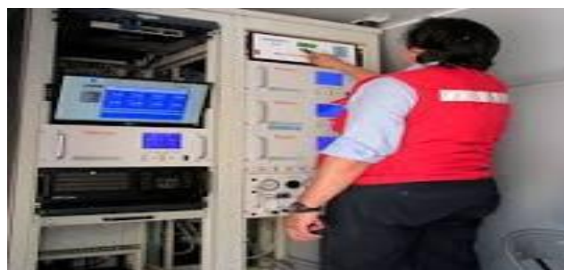
Figura 10: Sistema de Monitores para realizar medición de gases. Fuente: Elaboración Propia
