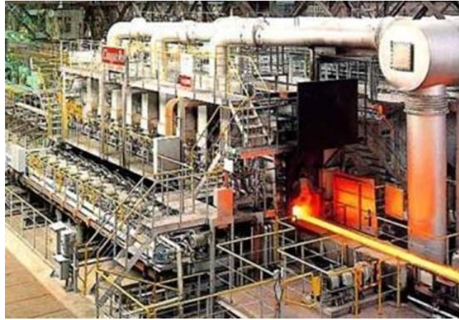
Figura 6: Horno de tratamiento térmico.
