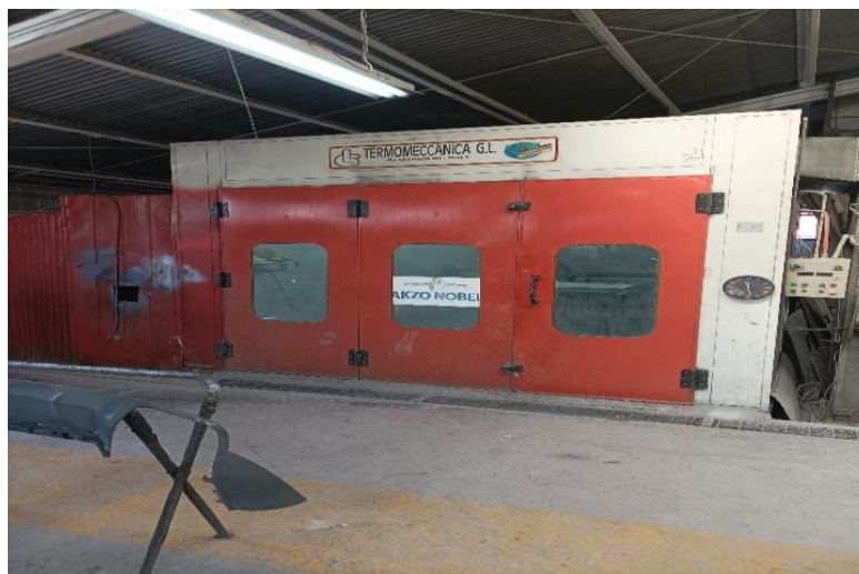
Figura 8: Cabina de Pintura. Fuente: Elaboración Propia
