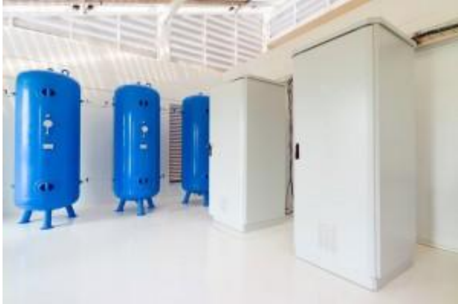
Figura 2.1; Tanques de hidrógeno, electrolizador y pila de combustible del sistema de almacenamiento de energía (Archivo: Proyecto Phi Suea)
