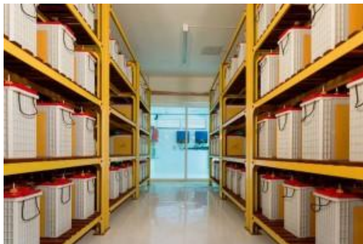
Figura 2.2: Bancos de baterías de plomo-ácido de 2000 Ah. (Archivo: Proyecto Phi Suea)
