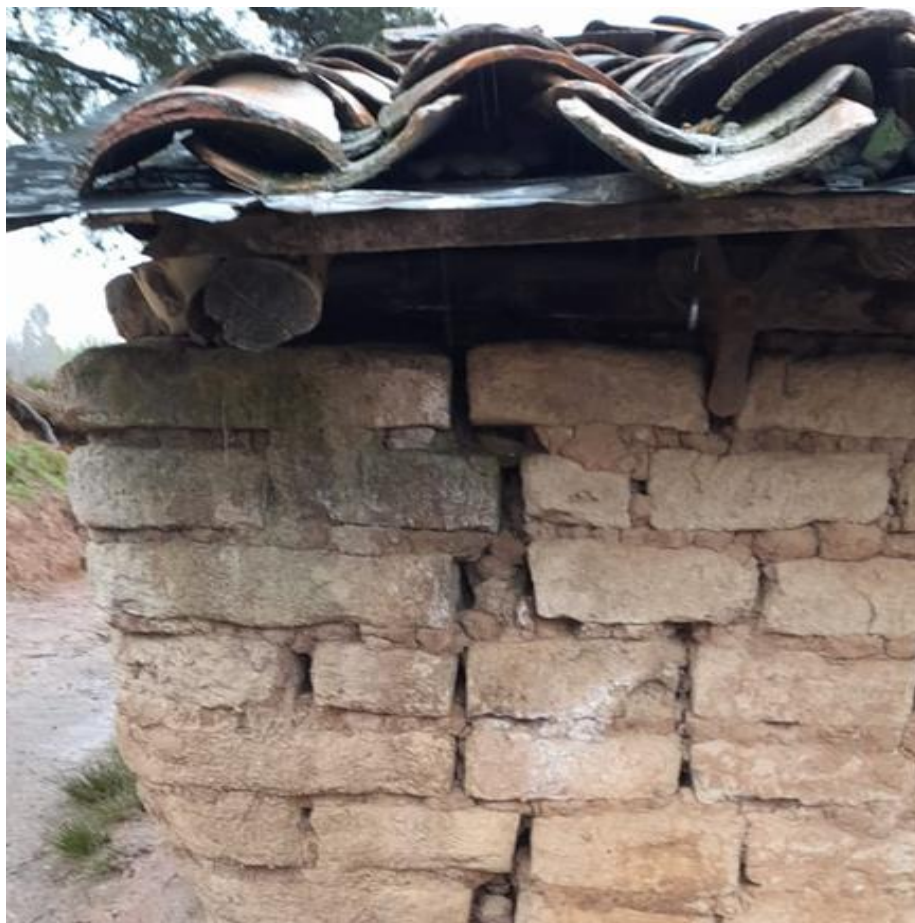
FIGURA 5: ADOBES CON EROSIÓN
