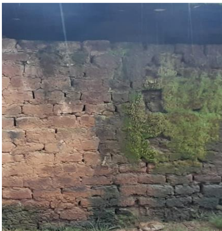
FIGURA 4: DAÑO POR HUMEDAD
