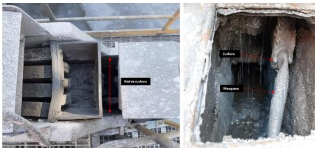
Figura 5 Zona de manguera
