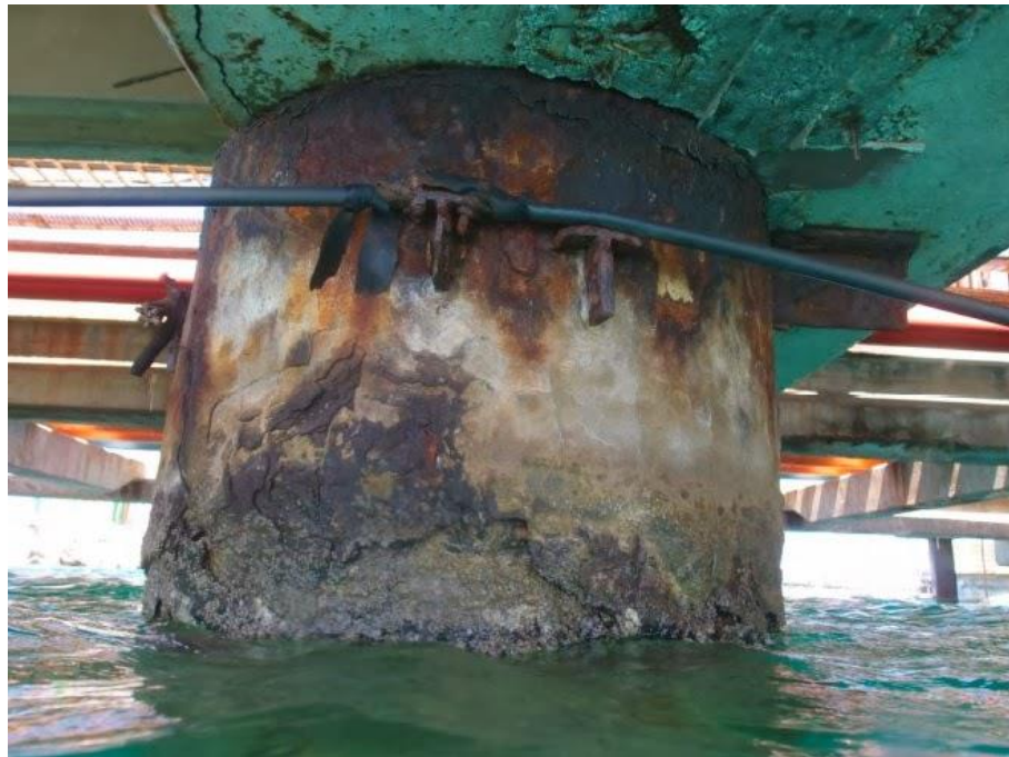
Figura 4: Corrosión en estructura de Hormigón producto de exceso de tensión (Martínez, 2014)
