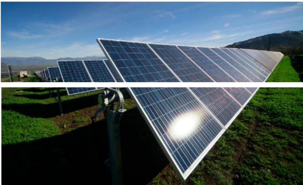
Planta fotovoltaica Quilapilún, ubicada en la Región Metropolitana. Foto: Francisco Castillo / Agencia Uno
