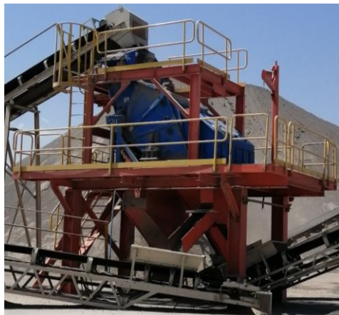
Figura 1-14: Harnero de la planta de áridos
