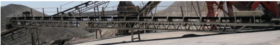
Figura 1-15: Cinta transportadora planta de áridos Terciaria Quilín Noviciado
