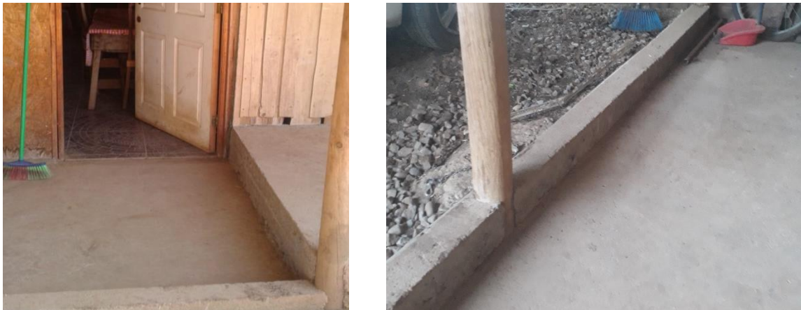
Imagen 1.15-16: Diferencias de nivel en hall acceso.
