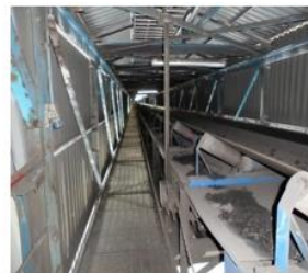
Imagen 2: interior banda transportadora
