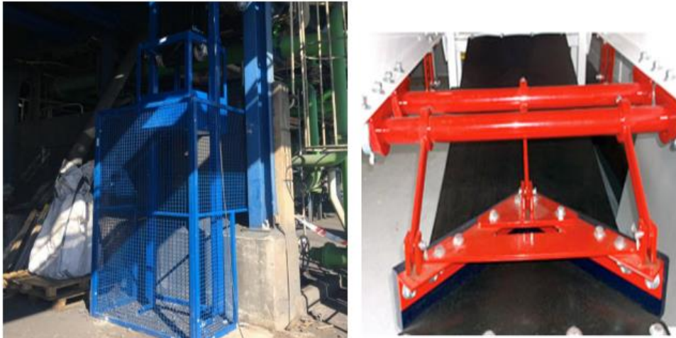
Figura 19. Tensores de gravedad (Contrapesos)
