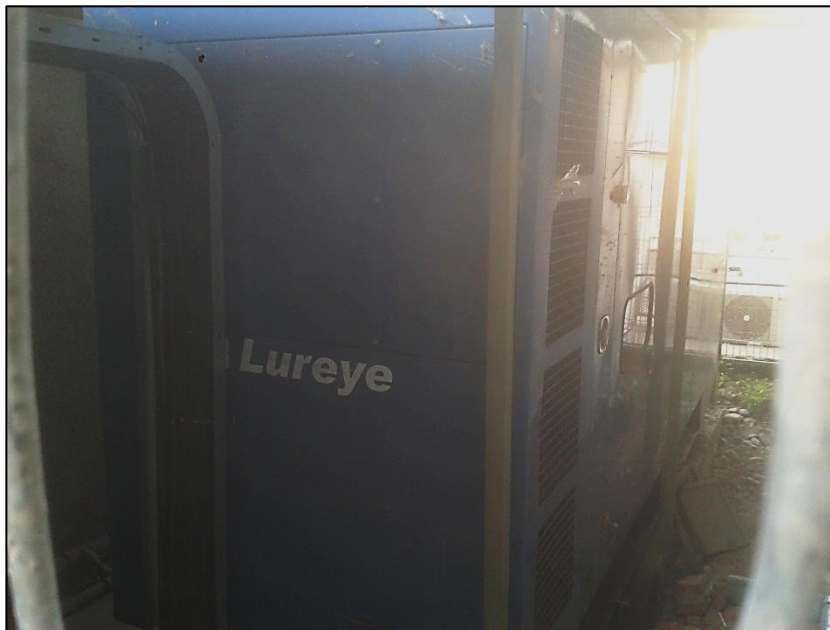
Figura 7: Motor diésel de respaldo para energizar el campus.
