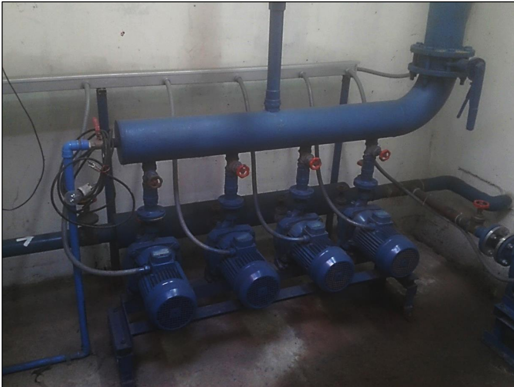
Figura 4: Pack de Bombas en la Sala de Bombas.
