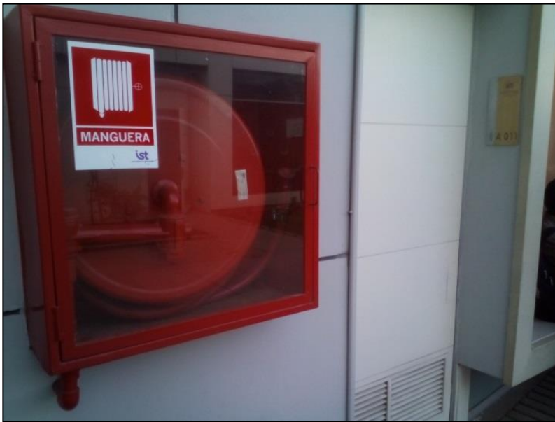
Figura 3: Gabinete de Manguera correspondiente a la Red Húmeda.
