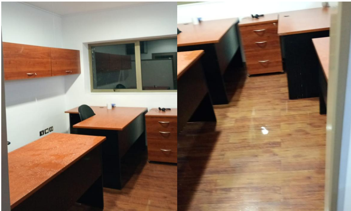
Imágenes 18 y 19: Filtraciones Oficinas Doctorado de Matemáticas
