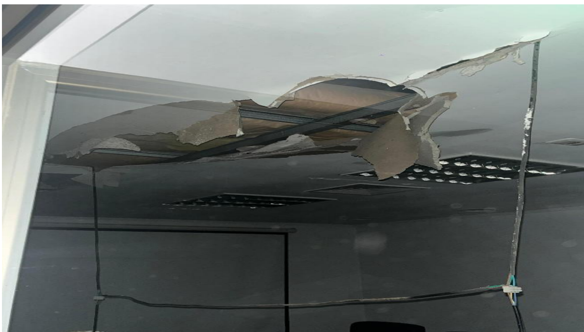
Imagen 25: Filtraciones salas de reuniones Centro de Idiomas
