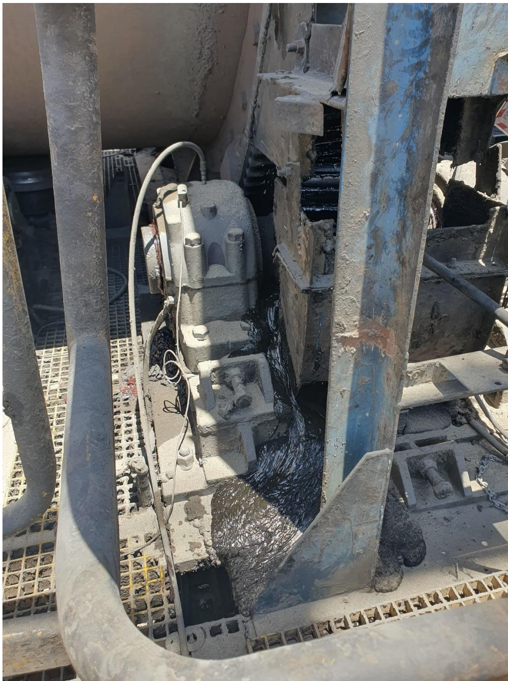
Figura 11.2.4: Derrames de grasa. (Fuente: Elaboración propia).
