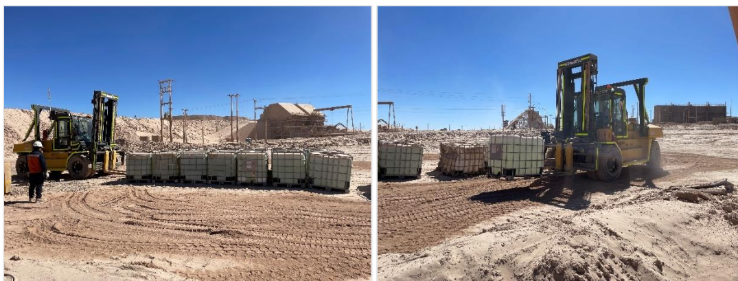
Figura 3.11: Grúa horquilla del área de mantención.
