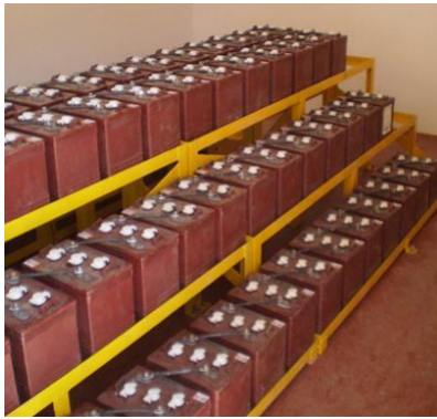
Figura 4.5: Banco de baterías de la MG a utilizar, extraída de [1].
