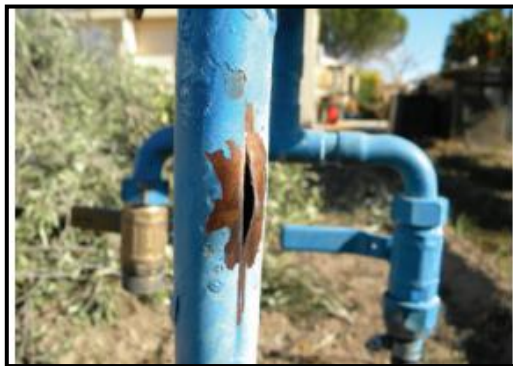
Ilustración 3-3, Fisura en tubería.
