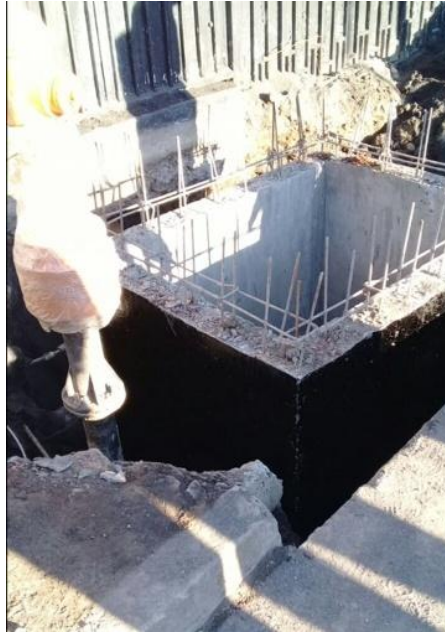
Ilustración 4-20, Impermeabilización en cámara de válvula.
