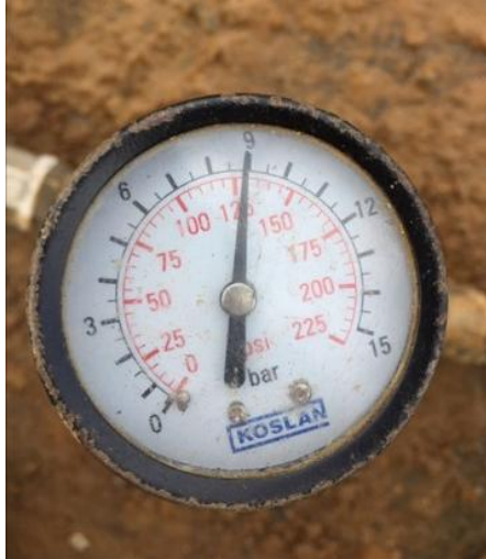
Ilustración 4-15, Manómetro indicando presión de prueba.
