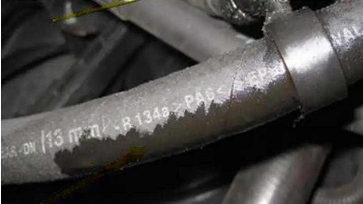
Figura 21: Filtración en flexible Hidráulico. Fuente: https://kingdaflex.com/es/how-to-repair-a-hydraulic-hose/
