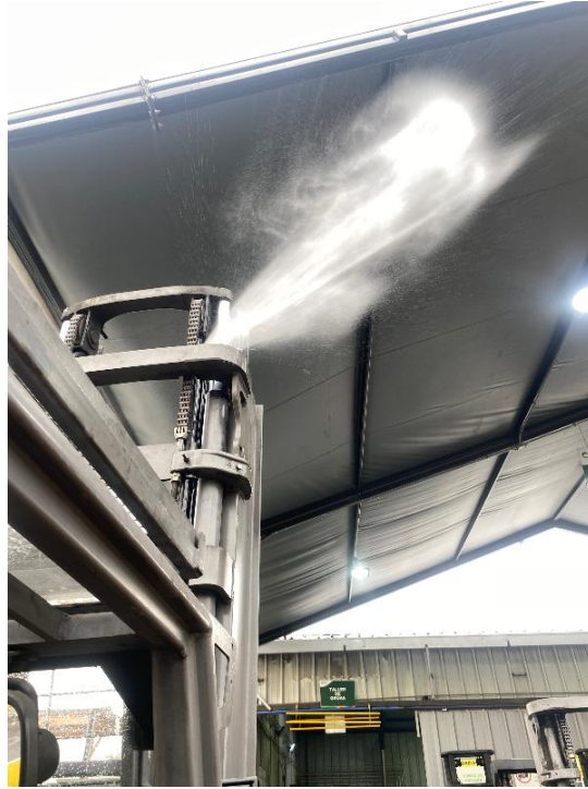
Figura 18: Fuga por Exceso de Presión en Flexible Hidráulico
