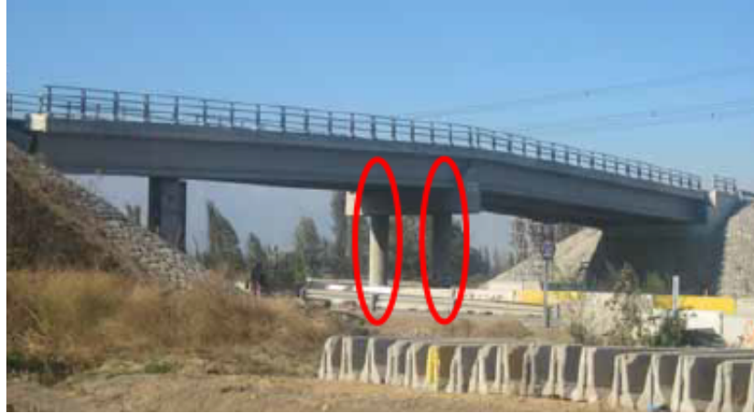
Figura 5.24: Columnas sin rotulación por efecto del terremoto del Maule, Puente Las Mercedes. Fuente: [7]
