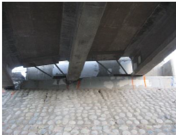
(b) Barras antisísmicas. Fuente: [4].
