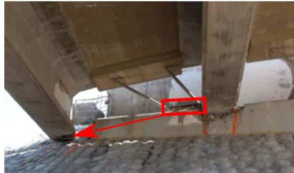
Figura 5.13: Daño observado en el terremoto del Maule en apoyos elastoméricos, Puente Las Mercedes. Fuente: [5]
