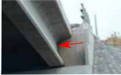
Figura 5.19: Daño en tablero producto del Terremoto del Maule, Puente Las Mercedes. Fuente: [6]
