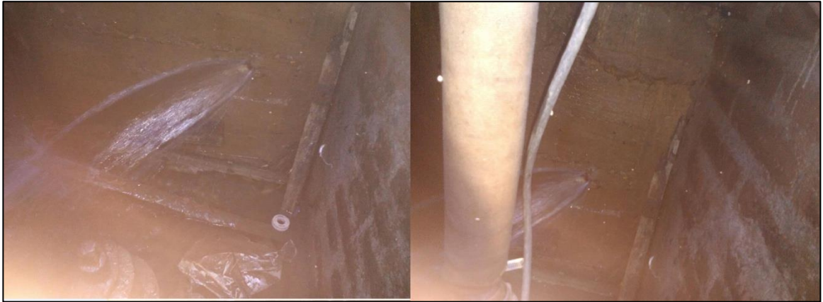
Figura 59: Fuga de arranque mal sellado. Fuente: Elaboración propia.
