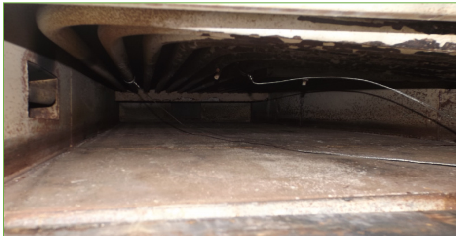
Figura 39: Instalación termocuplas cámara de cocción.
