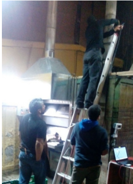
Figura 42: Medición de gases
