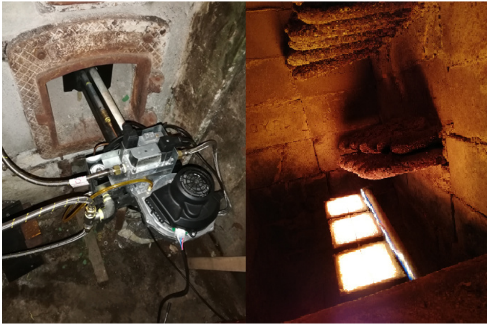
Figura 41: Implementación quemador cámara de combustión.
