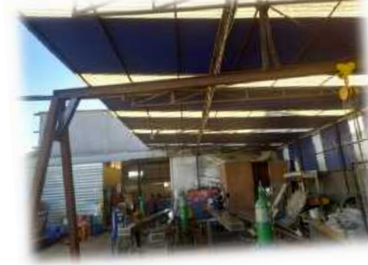
Figura 2- 12. No existe iluminación fija en taller externo.
