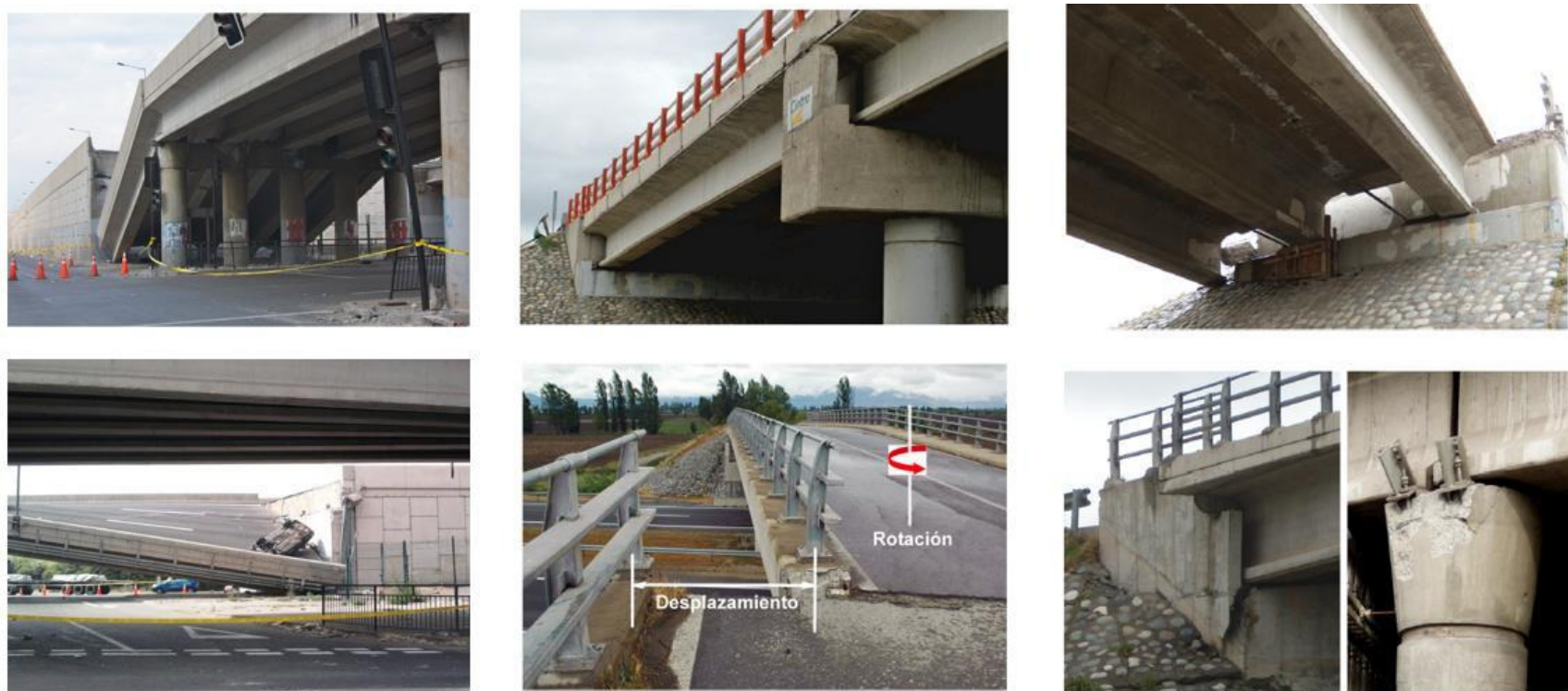
Figura 3: Daños asociados a desplazamientos y rotaciones tras la ocurrencia de impacto, Terremoto Maule 2010. Fuente: Schexnayder et al., (2014).
