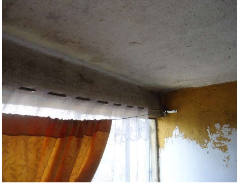
Figura 2-7: Estado de los Depto.
