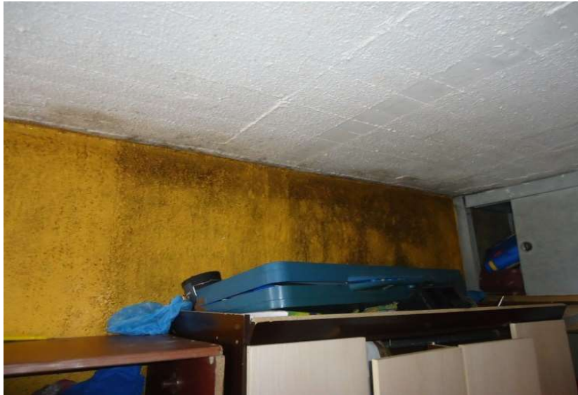
Figura 2-6: Estado de los Depto.
