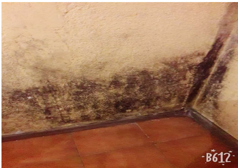
Figura 2-9: Estado de los Depto.
