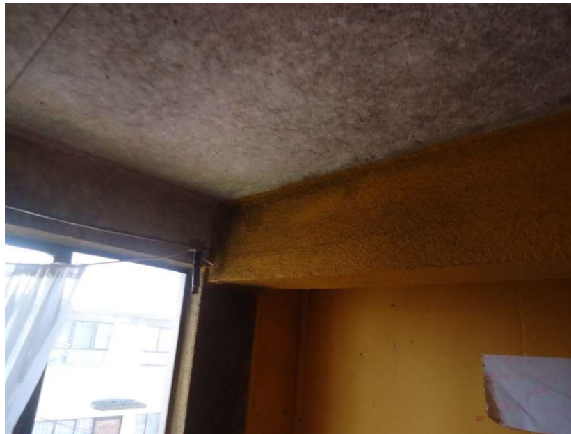
Figura 2-8: Estado de los Depto.
