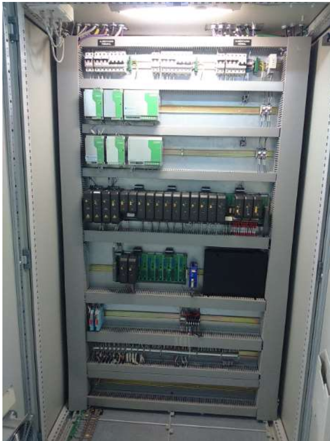
Figura 4.2 Tablero de control.
