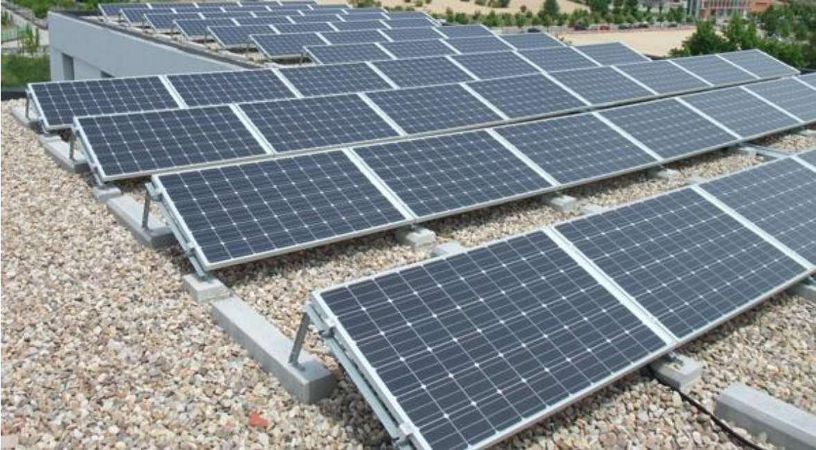
Imagen 8. Granja de paneles fotovoltaicos.
