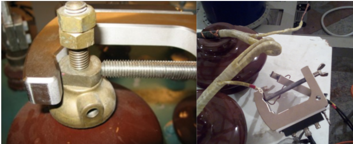
Figura 4.23: Comparación de conexión de conector original entre bushing de transformador y en bobina preformada.
