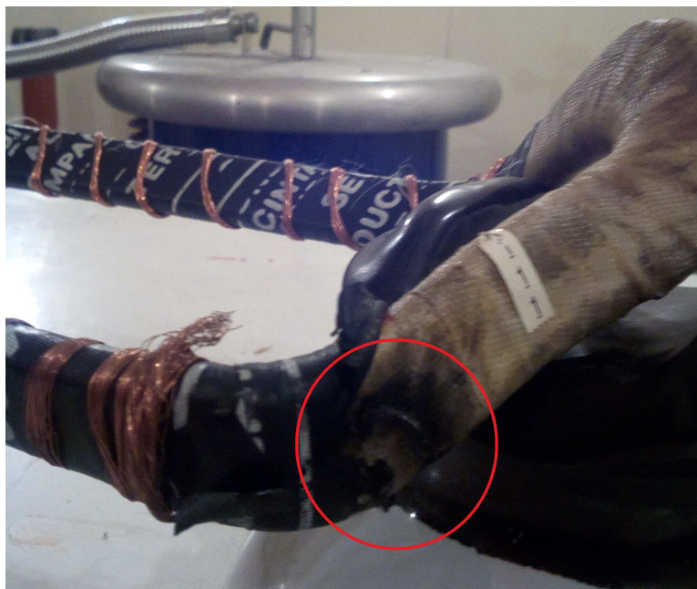
Figura 4.32: Bobina 3 - falla preexistente
