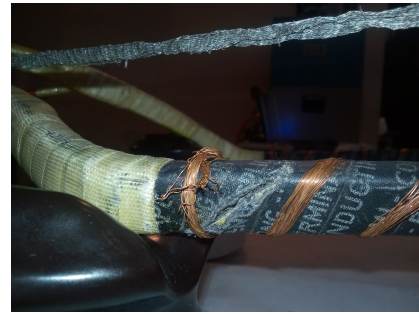
Figura 6.24: Embarrilado de cobre sobre aislamiento dañado.
