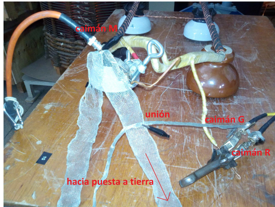
Figura 4.7: Conexión de pantallas a tierra para ensayo GR2 M1.
