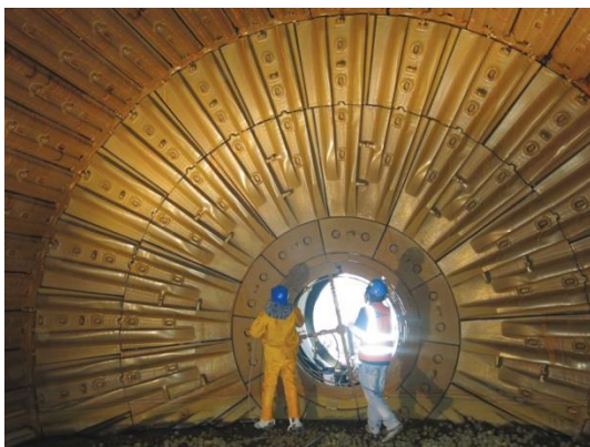
Interior de molino con revestimientos de acero fundido instalados.
