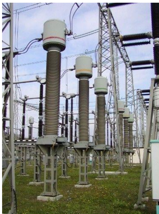
Figura 2.9: Transformadores de corriente en una SE.
