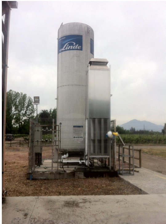
Figura 10: Instalación Equipo de CO_2
