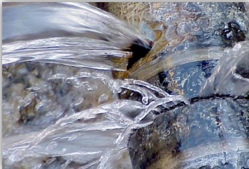
Figura 2-1: Falla en Tubería
