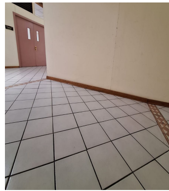
Figura 3.9. Desnivel de 6,5 cm en el piso del pasillo NLoS.
