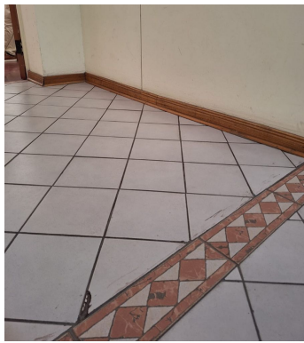
Figura 3.8. Desnivel de 5 cm en el piso del pasillo LoS.
