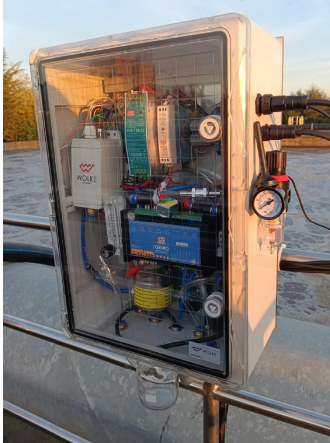
Figura 5.2: Gabinete de captación de gases
