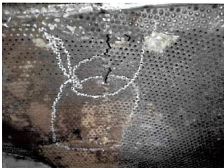
Ilustración 1-14 Evidencia de rotura en harneros
