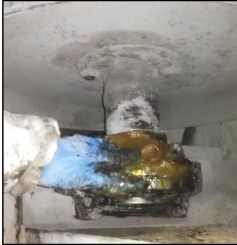
Figura 4.5 - Lubricación manual contaminando rodamientos.
