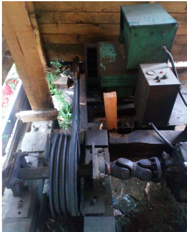
Figura 12: Generador trifásico B
