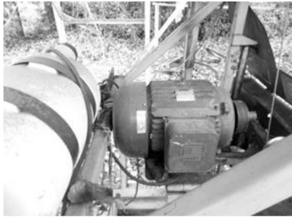
Figura 2: Motor eléctrico 10 HP
