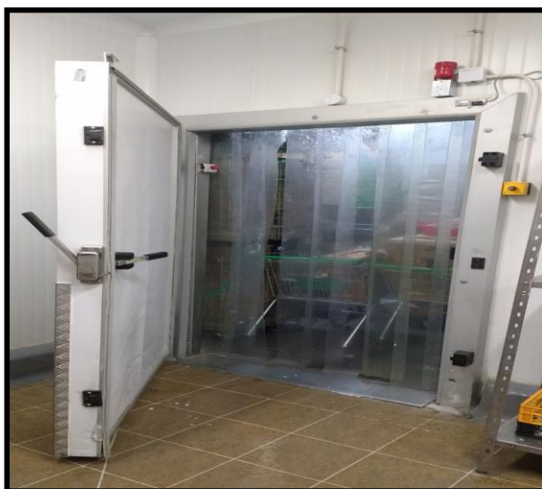
Figura 2.1 Cámara de productos congelados.
