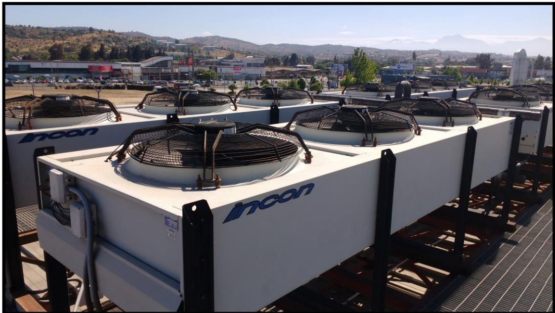
Figura 2.11 Condensadores ubicados en zona externa.
