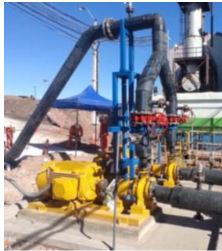
Figura 14: Configuración de bombas en Coya Sur
