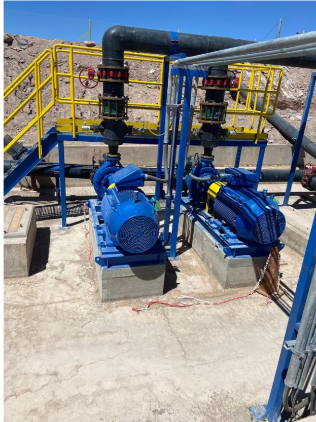
Figura 11: Configuración bombas de agua Toco Sur.
