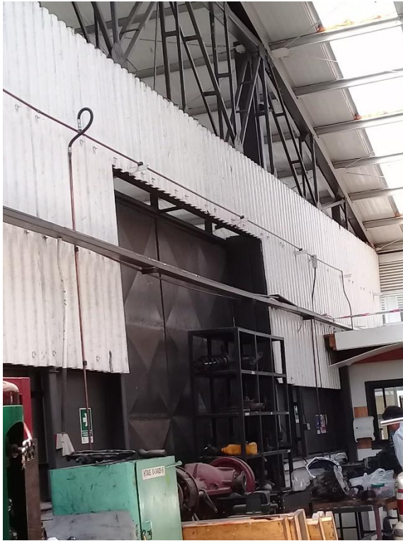
Fotografía N°22. Redes eléctricas, bandeja principal de distribución.
