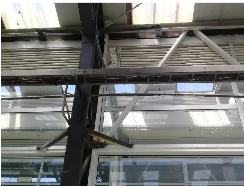
Fotografía N°27. Redes eléctricas, bandeja principal de distribución.
