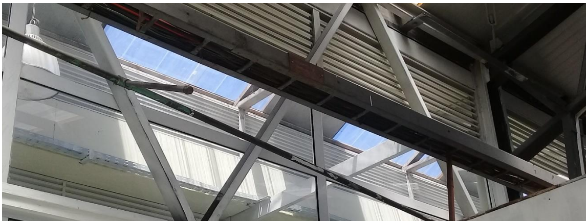
Fotografía N°19. Redes eléctricas, bandeja principal de distribución.
