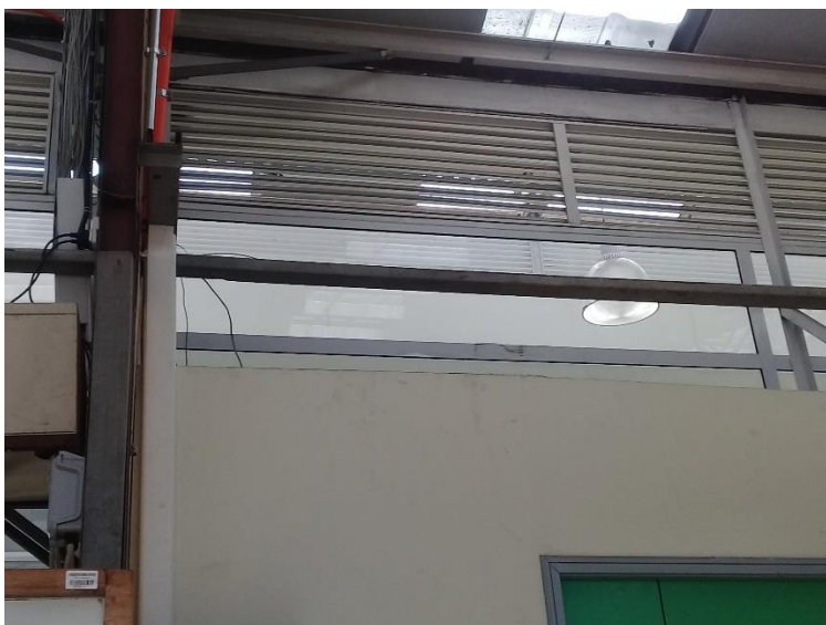
Fotografía N°8. Redes eléctricas, bandeja principal de distribución.
