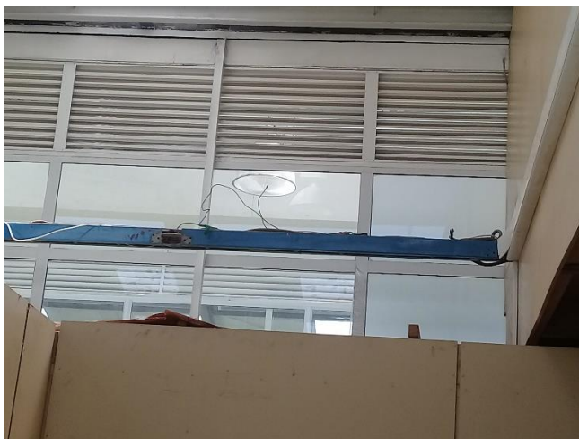
Fotografía N°14. Redes eléctricas, bandeja principal de distribución.
