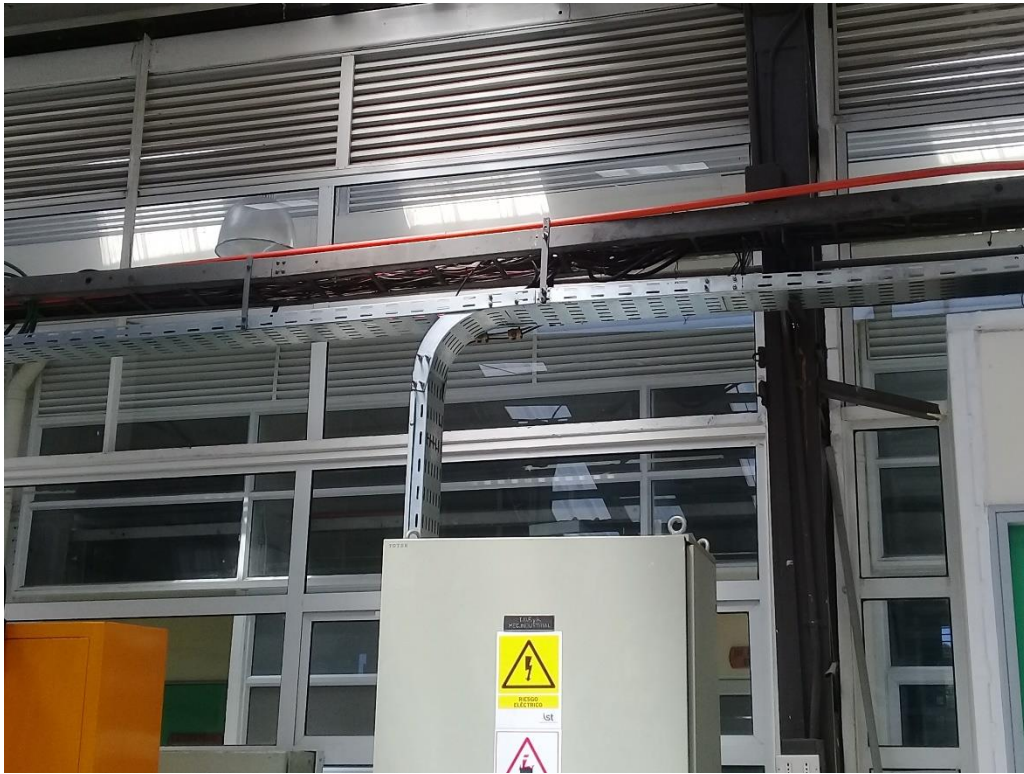
Fotografía N°29. Redes eléctricas, bandeja principal de distribución antigua y nueva.
