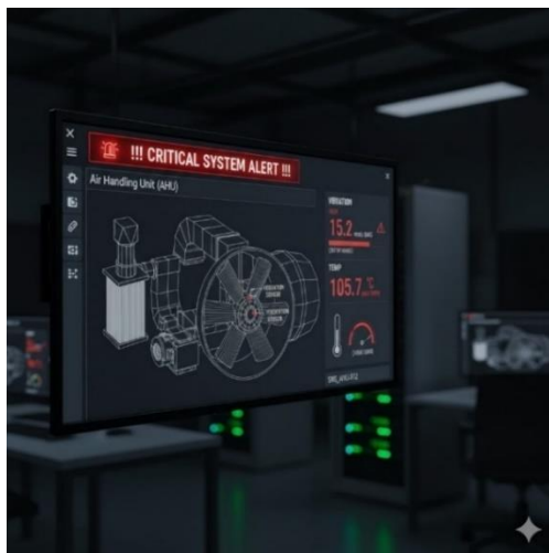
Ilustración 14: Proyección del sistema de monitoreo en SCADA.
