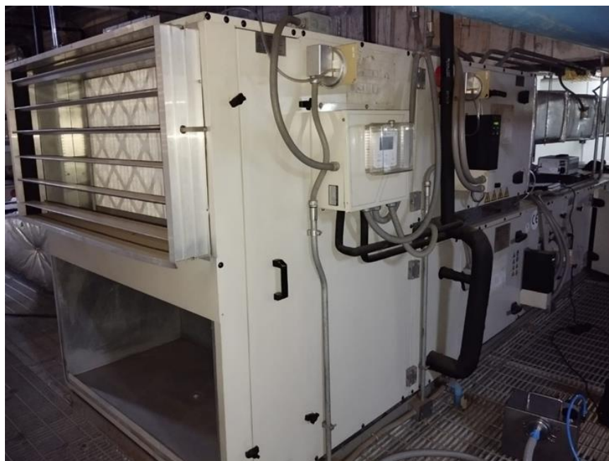
Ilustración 1: Unidad Manejadora de Aire Marca TRANE
