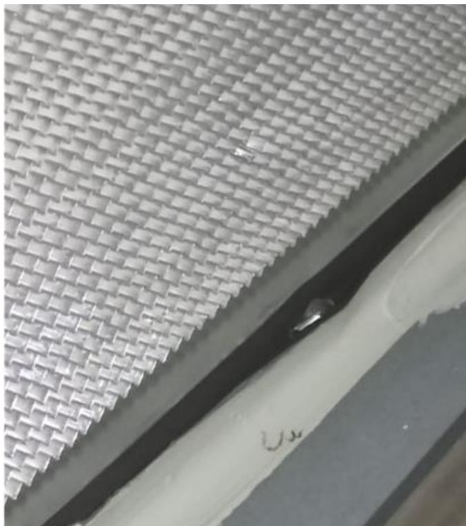
Ilustración 2: Filtro HEPA con fuga perimetral debido a un cuerpo extraño en su mala instalación
