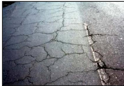
Figura 2.4 Pavimento flexible que presenta agrietamiento por fatiga [27].
