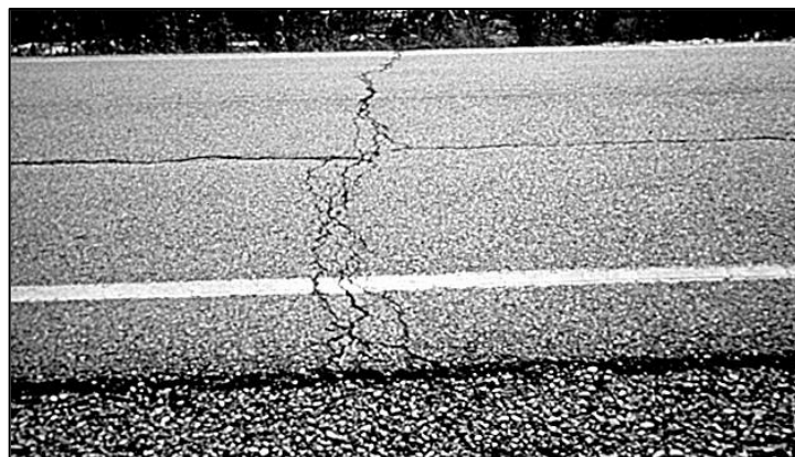
Figura 2.2 Agrietamiento térmico en pavimento flexible. [27]
