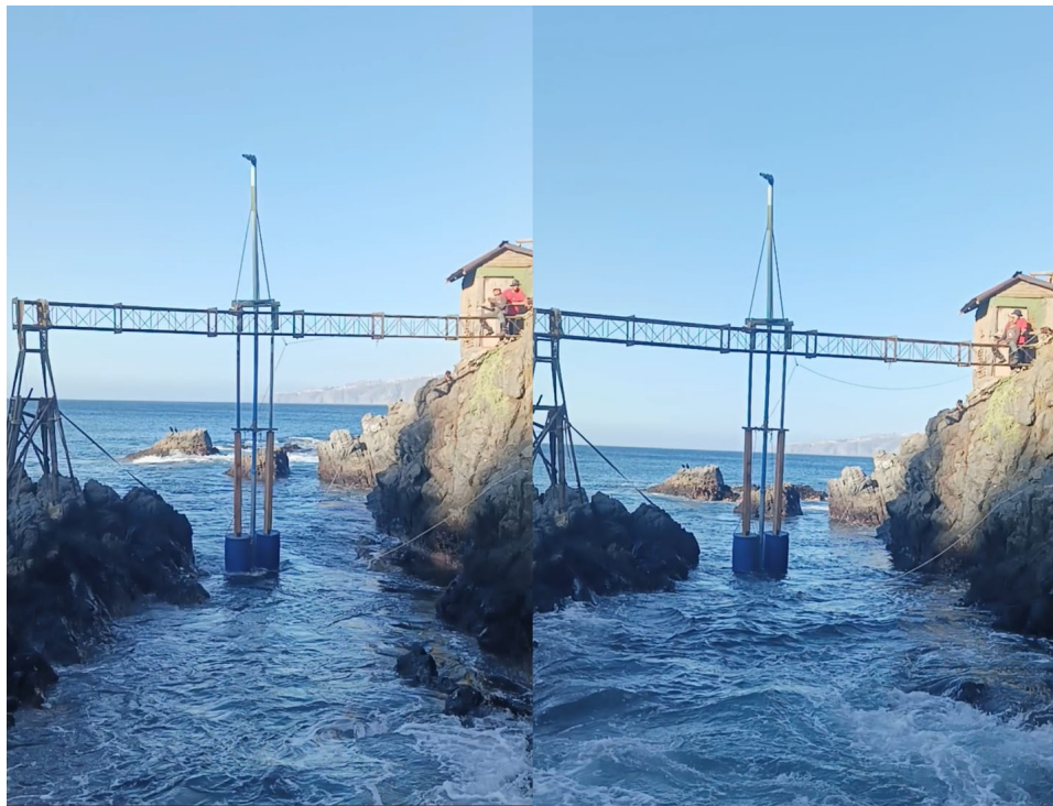
Figura 26: Ciclo de bombeo equipo Wasserdrachen IV instalado en Curaumilla.
