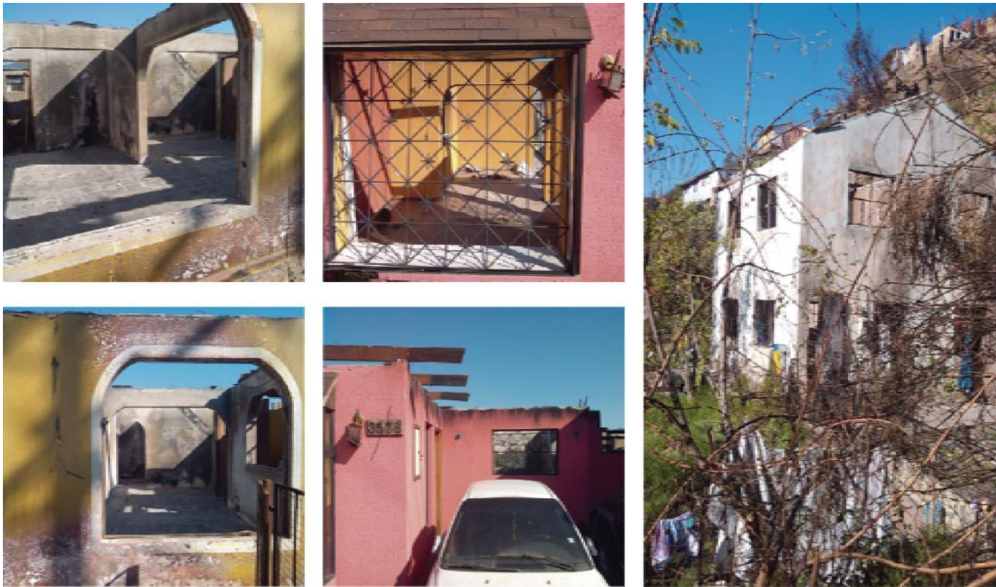
(Figura 4 – Casas de Albañilería Reforzada Incendio 2013 Cerro Barón – Rodelillo)
