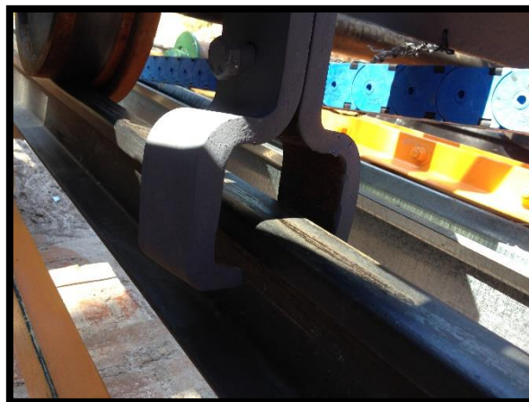
Figura 2.8: Sistema de Protección Antivuelco de Carro 1 Fuente: Elaboración Propia
