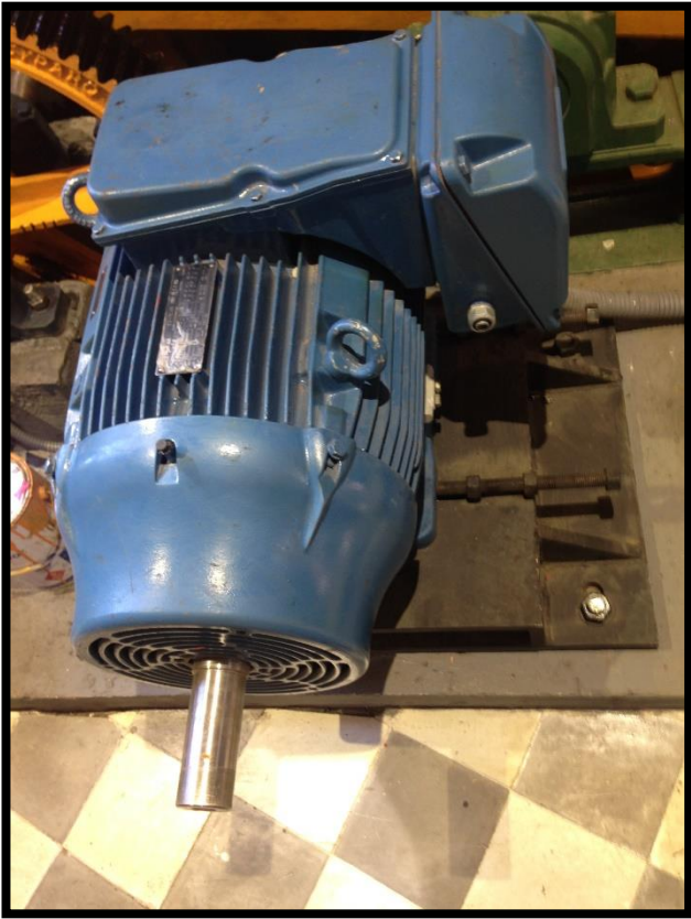
Figura 2.13: Motor Eléctrico en Estación Superior Fuente: Elaboración Propia
