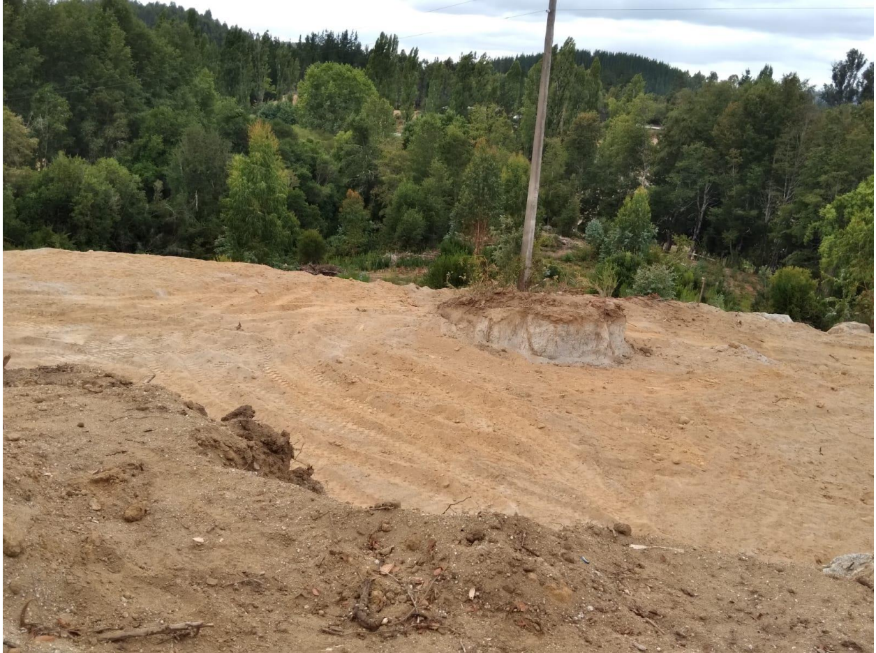
Ilustración 38: Fotografía tomada desde el tercer nivel, Ubicación Poste eléctrico transmisión. (Fuente propia)
